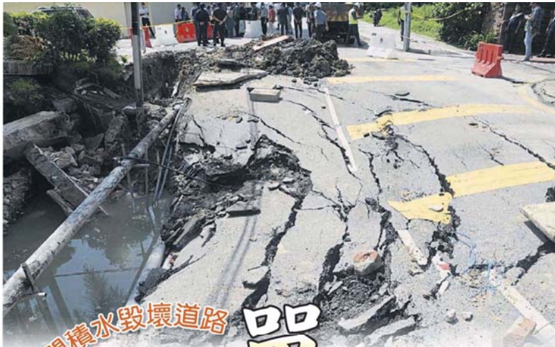
水管破裂，以致路面塌陷形成路洞。
