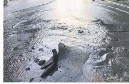
■萬美路也在本月14日發生水管破裂，所幸未形成路洞。（照片取自網站）
